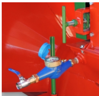
MEDIDOR DE VAZÃO DE ÁGUA
